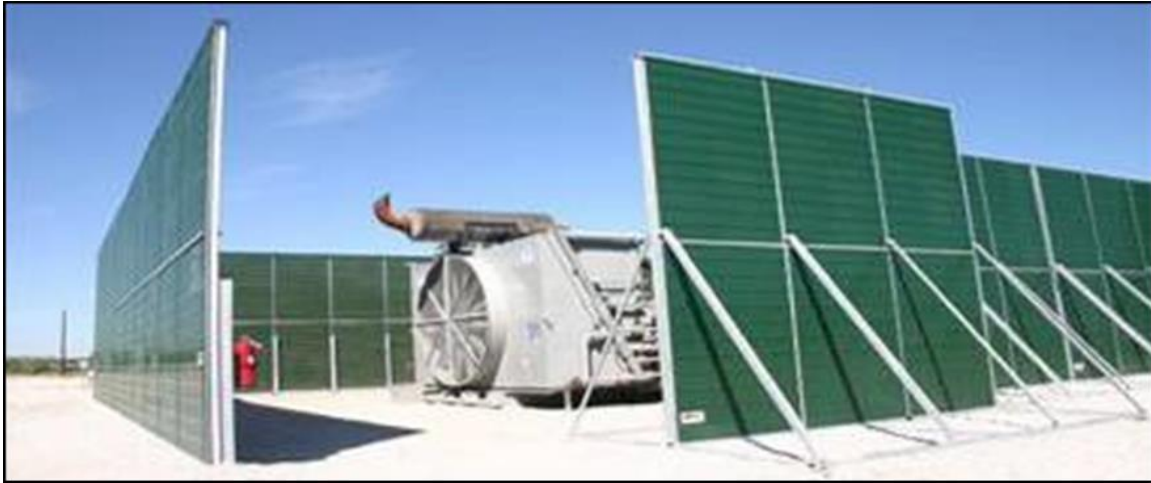
Εικόνα 5: Παράδειγμα χρήσης ηχοπετασμάτων σε σταθερές πηγές θορύβου
