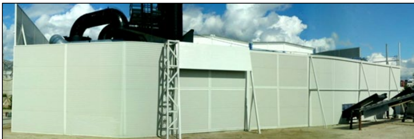
Εικόνα 13: Παράδειγμα χρήσης ηχοπετασμάτων σε σταθερές πηγές θορύβου
