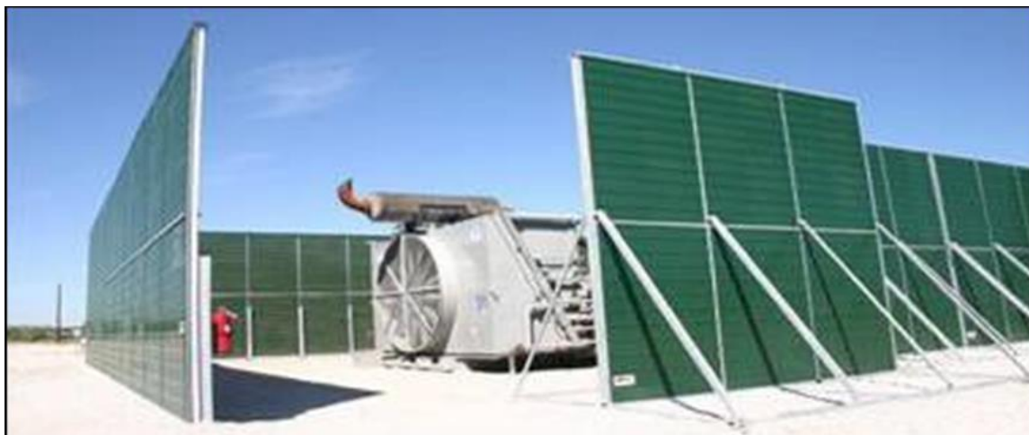
Εικόνα 6: Παράδειγμα χρήσης ηχοπετασμάτων σε σταθερές πηγές θορύβου
