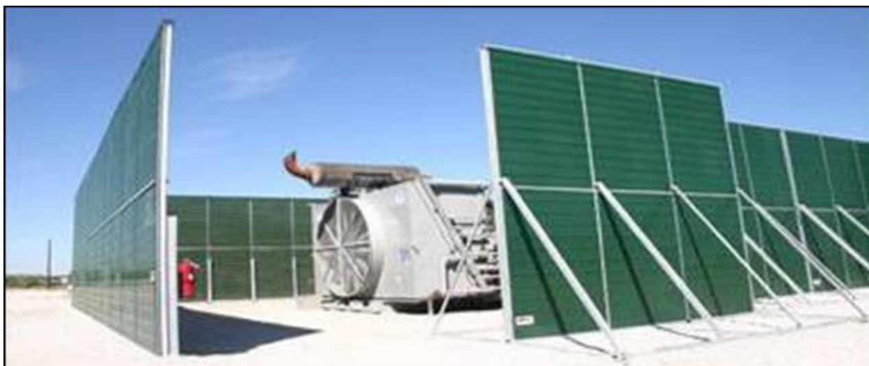
Εικόνα 6: Παράδειγμα χρήσης ηχοπετασμάτων σε σταθερές πηγές θορύβου
