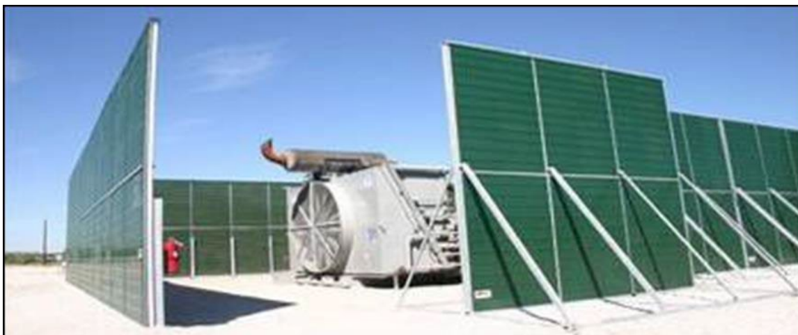
Εικόνα 6-1: Παράδειγμα χρήσης ηχοπετασμάτων σε σταθερές πηγές θορύβου
