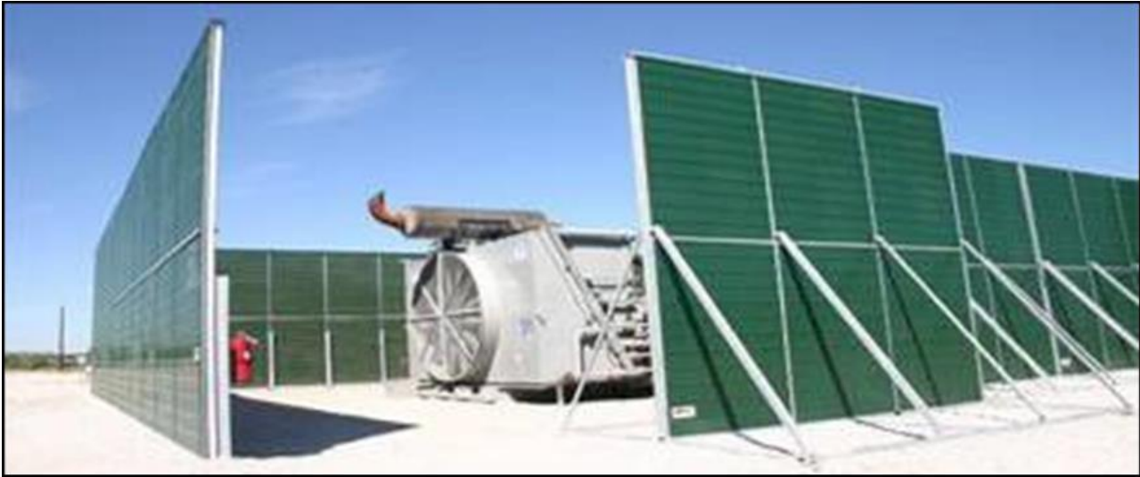
Εικόνα 6: Παράδειγμα χρήσης ηχοπετασμάτων σε σταθερές πηγές θορύβου
